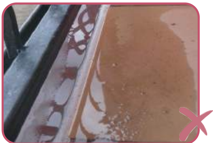
NIEWŁAŚCIWE ODPROWADZENIE WODY Z POSADZKI
